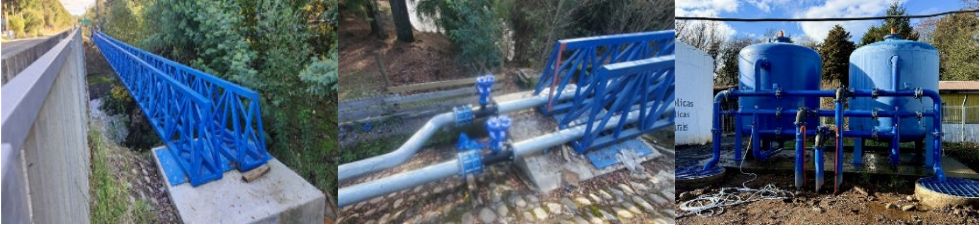
Foto: Sistema de APR Ilauillau, sector El Pirao, comuna de Villarrica.
