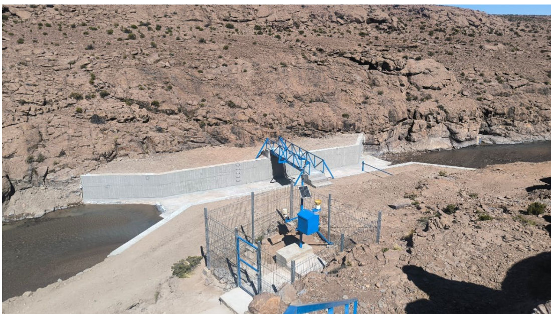
Conservación Estación Fluviométrica Quebrada Camiña en Tarcavire
