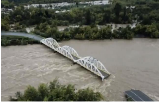
Situación bajo afectación en puente Tres Arcos
