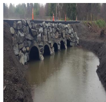
Conectividad de calle de servicio restituida, con solución provisoria de obra de arte colapsada.
