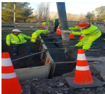
Se realiza relleno con hormigón tras espaldar de estribos norte puentes Batuquito oriente y poniente
