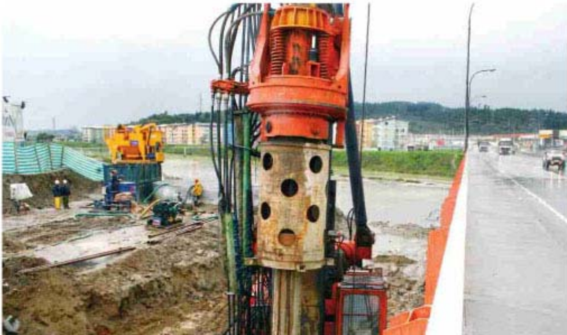
Imagen 4: Faena de Incapilotes, etapa básica para el inicio de la estructura del viaducto.
